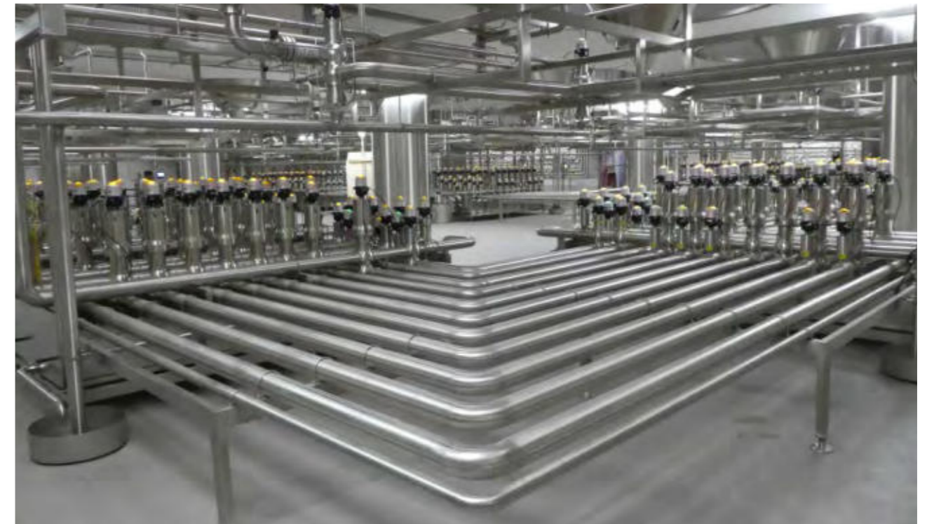
Vollautomatischer Gärkeller bei Forst in Algund, die größte Brauerei in Südtirol, 2020-21 von der Handmann Armaturenfabrik installiert.
