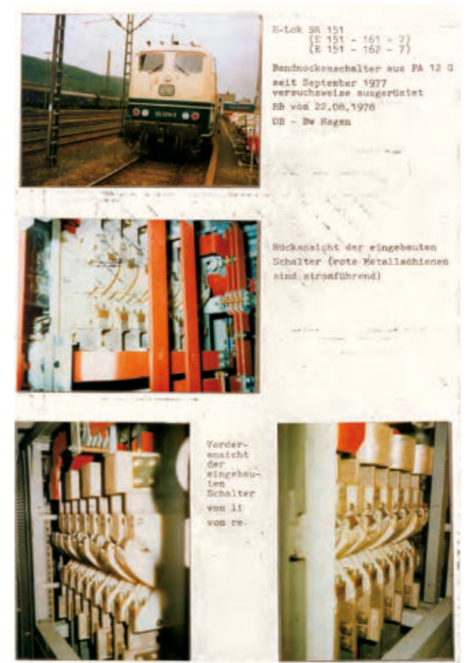
Versuchsweise rüstet die Handtmann Elteka den Antrieb der E-Lok BR 151 der Deutschen Bahn mit Bandnockenschaltern aus Lauramid® aus, Originalseite aus dem Auftrag 1977
