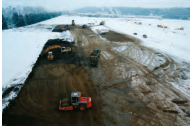
Beginn der Planierungsarbeiten für den Neubau der Handtmann Maschinenfabrik, Biberach, Gewerbegebiet Aspach, 1999
