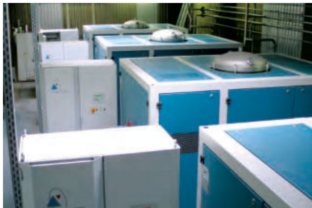
Acht Verdampferanlagen destillieren das im Druckguss anfallende Abwasser, bis zu 200 Kubikmeter am Tag, Handtmann Metallgusswerk, Biberach 2017.
