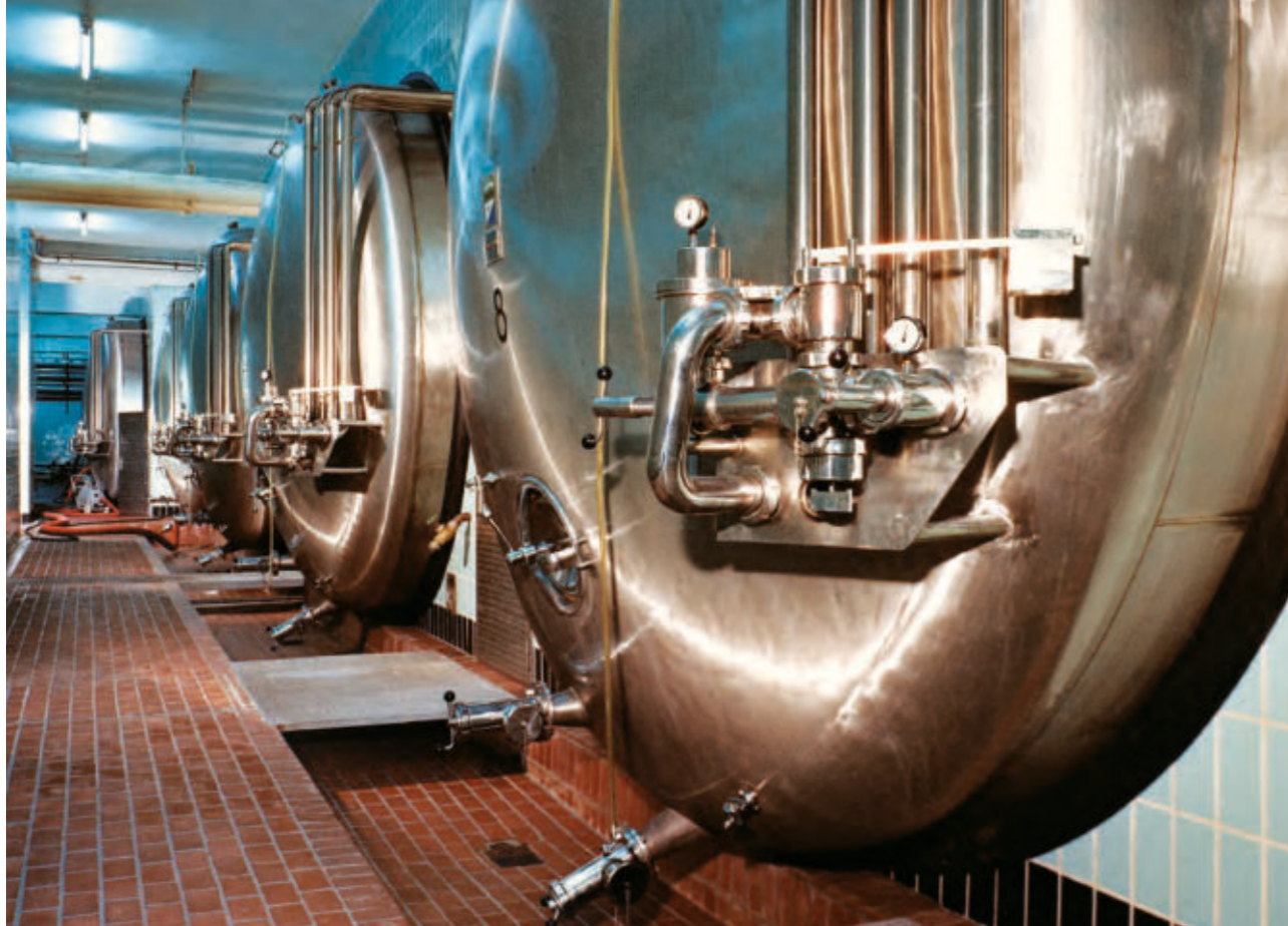
Handtmann-Kolbenschieber an Tanks im Gärdruckkeller der Wickküler Brauerei in Wuppertal, 1970
